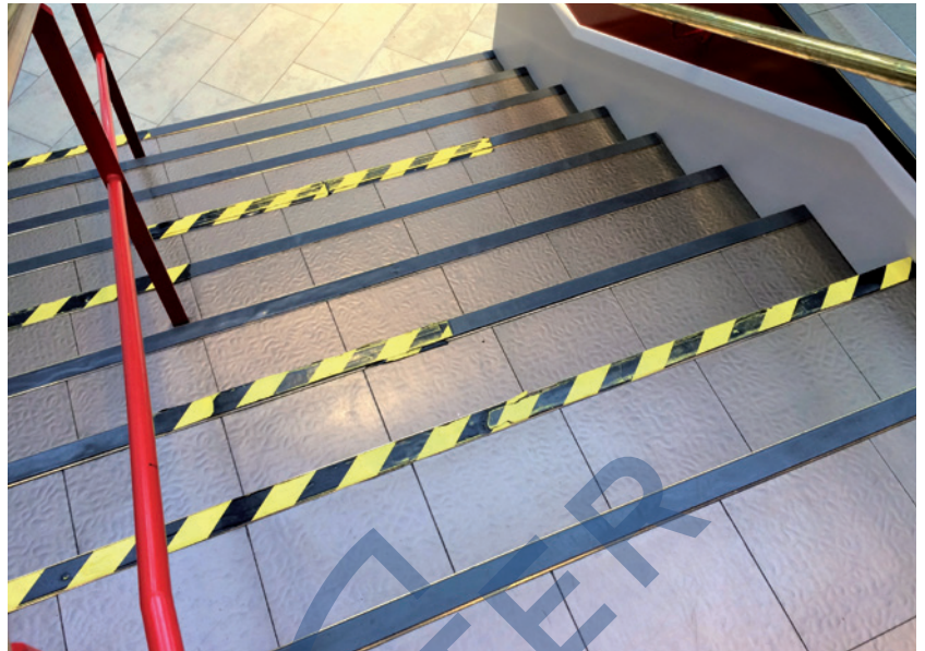
ABB. 8: Unzureichende Stufenmarkierungen durch Klebemarkierungen
