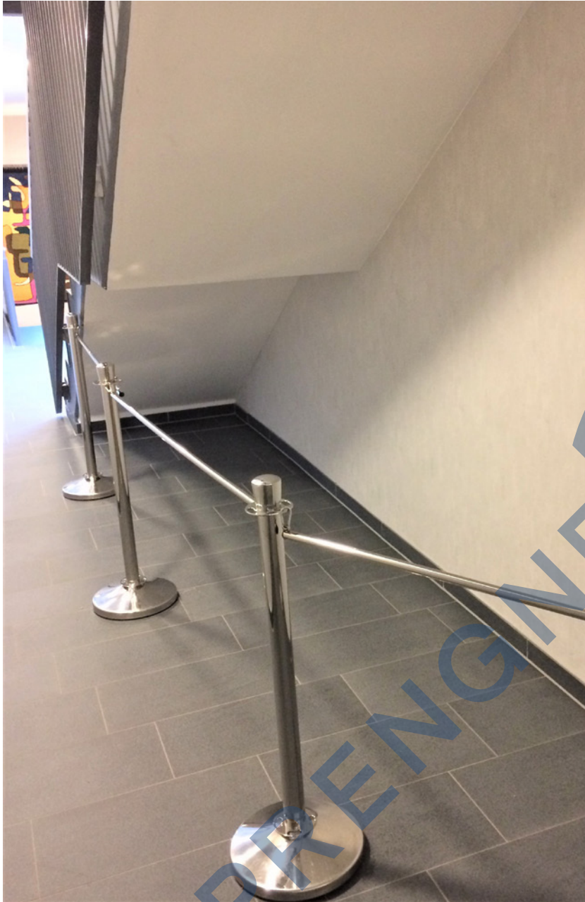
ABB. 6: Treppenlauf mit notdürftiger Absicherung der Gefahr des Unterlaufens
